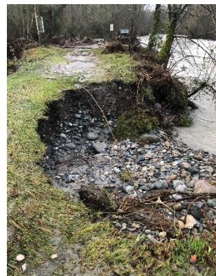
Le même chemin après la crue
